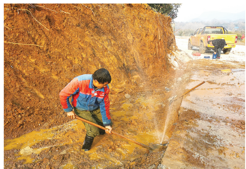
随着寒潮来袭,供水设施将面临考验。近日,创水务抢修工作人员在加紧排查,对室外水井盖进行检修和防护保暖,保障城市正常供水。 郭少军 杨华 摄
