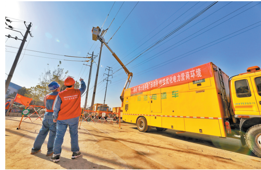
11月25日,芜湖供电公司员工沈显高等人在芜湖市政务新区10千伏鸠阳122线4号杆处,以不停电作业方式开展企业用电负荷切换。 何煜 供图
